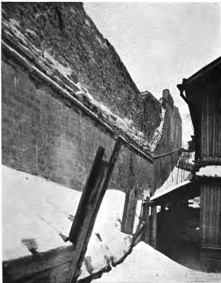
Разрушеніе стѣны путемъ отслаиванія.
