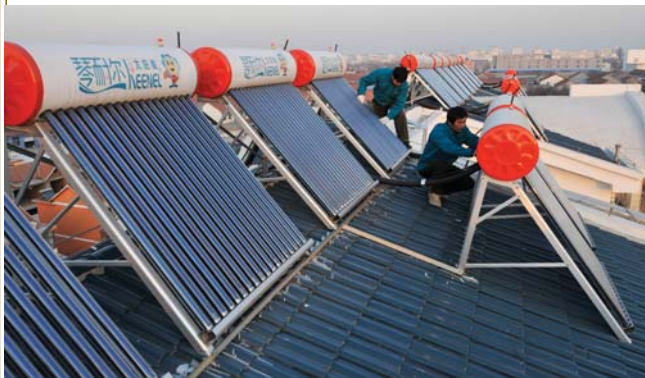
В КИТАЙСКОМ ГОРОДЕ ЖИЧЖАО на крышах зданий установлены тысячи солнечных водонагревателей, что уменьшает потребление электроэнергии для получения горячей бытовой воды
