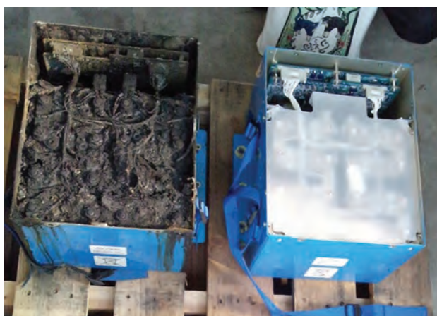
Сгоревшая и целая аккумуляторные батареи
