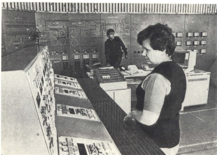
Главный пульт очистных сооружений Байкальского целлюлозно-бумажного комбината
