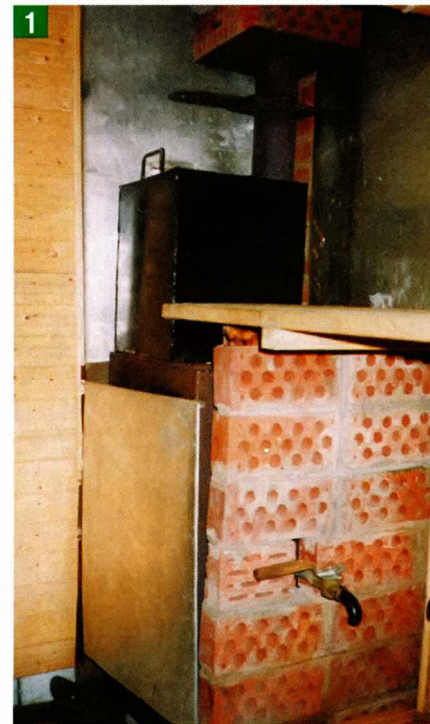
Печь-каменка с водогрейным баком расположена в парном отделении за защитной кирпичной стенкой.
