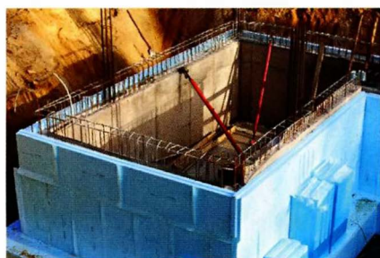
Теплоизоляции подвала с наружной стороны начинают на этапе строительства фундамента и цокольного этажа.
