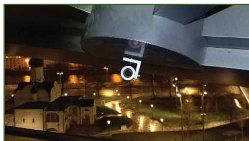
Деформационная марка с L-образным креплением на соединительном узле «Бабочка» каркаса конструкции «Стеклянная кора»
