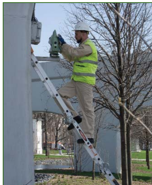
Монтаж электронного тахеометра для наблюдения за деформациями консоли смотровой площадки «Парящий мост»
