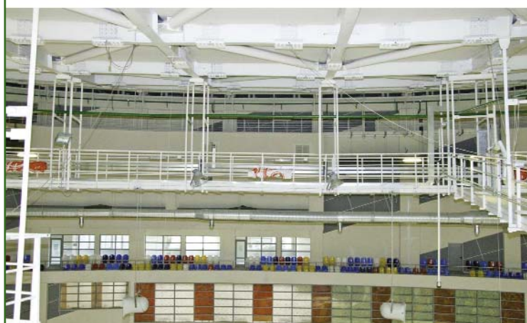
Рис. 2 Общий вид кровли со стороны улицы (вверху) и со стороны зрительного зала (внизу)
