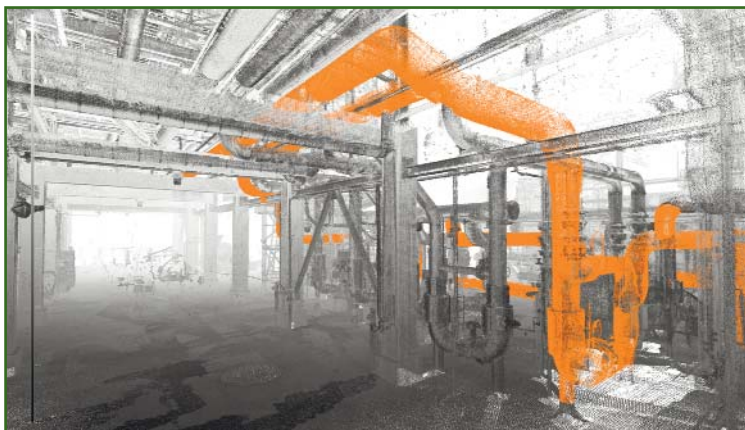
Рис. 2 Цветовое кодирование облака точек инженерных коммуникаций, полученное в результате наземного лазерного сканирования
