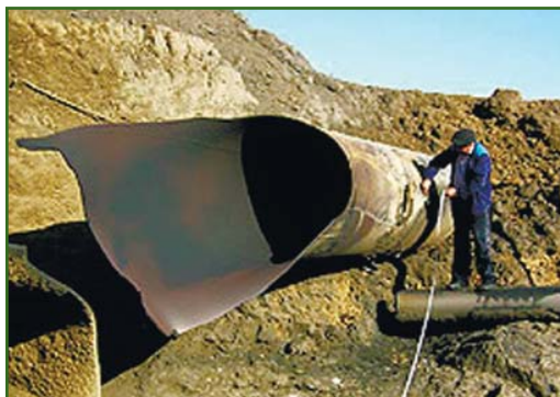
Рис. 2 Последствия разрыва трубопровода
