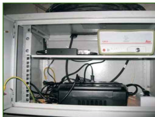
Рис. 2 Приемник и элементы питания, расположенные в коммуникационном шкафу
