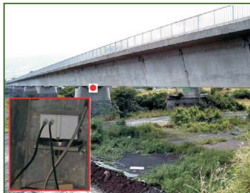
Рис. 3 Пример установки инклинометра для измерения смещения (наклона) опоры моста
