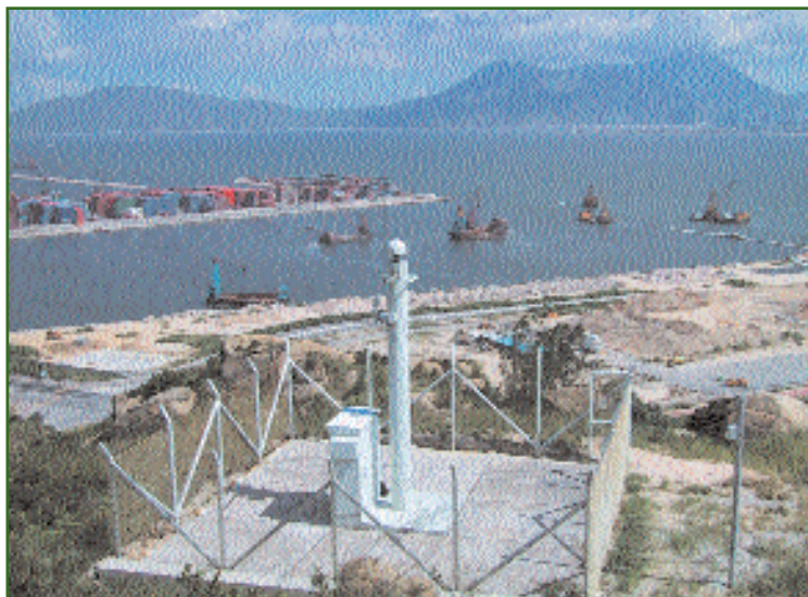
Рис. 1 Базовая станция, установленная в порту
