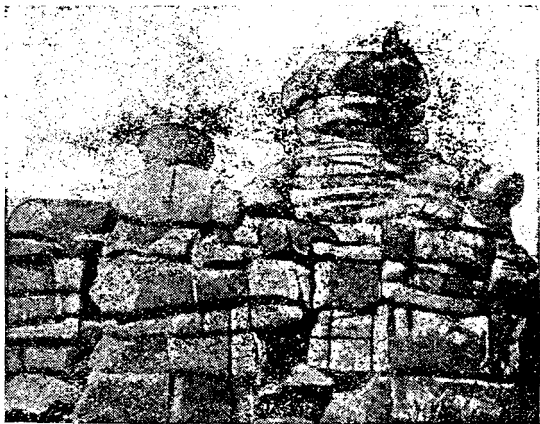
Фиг. 5. Матрацеобразная отдельность: гранитный массив под влиянием разрушающего действия воздуха, воды и смены температур разбит горизонтальными и вертикальными трещинами
