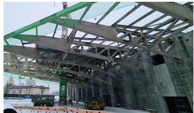
Рис. 12. Общий вид узлов сопряжения в зоне опирания стальных ферм на монолитные конструкции до бетонирования Fig. 12. General view of the coupling nodes in the area of the support of steel trusses on monolithic structures before concreting
