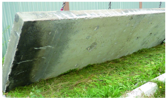
Рис. 8. Вид обогреваемой поверхности плиты контрольной серии 7 (из обычного тяжелого бетона) после огневого испытания. Класс бетона – В30. Присутствуют два локальных скола бетона
